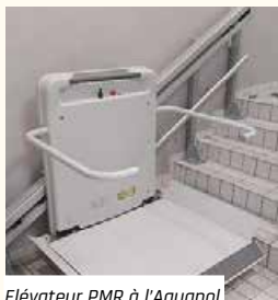
Élévateur PMR à l'Aquapoli
