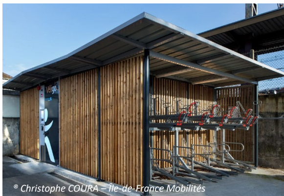
Brunoy : installation de racks en double-étage en libre-accès accolés à une consigne
